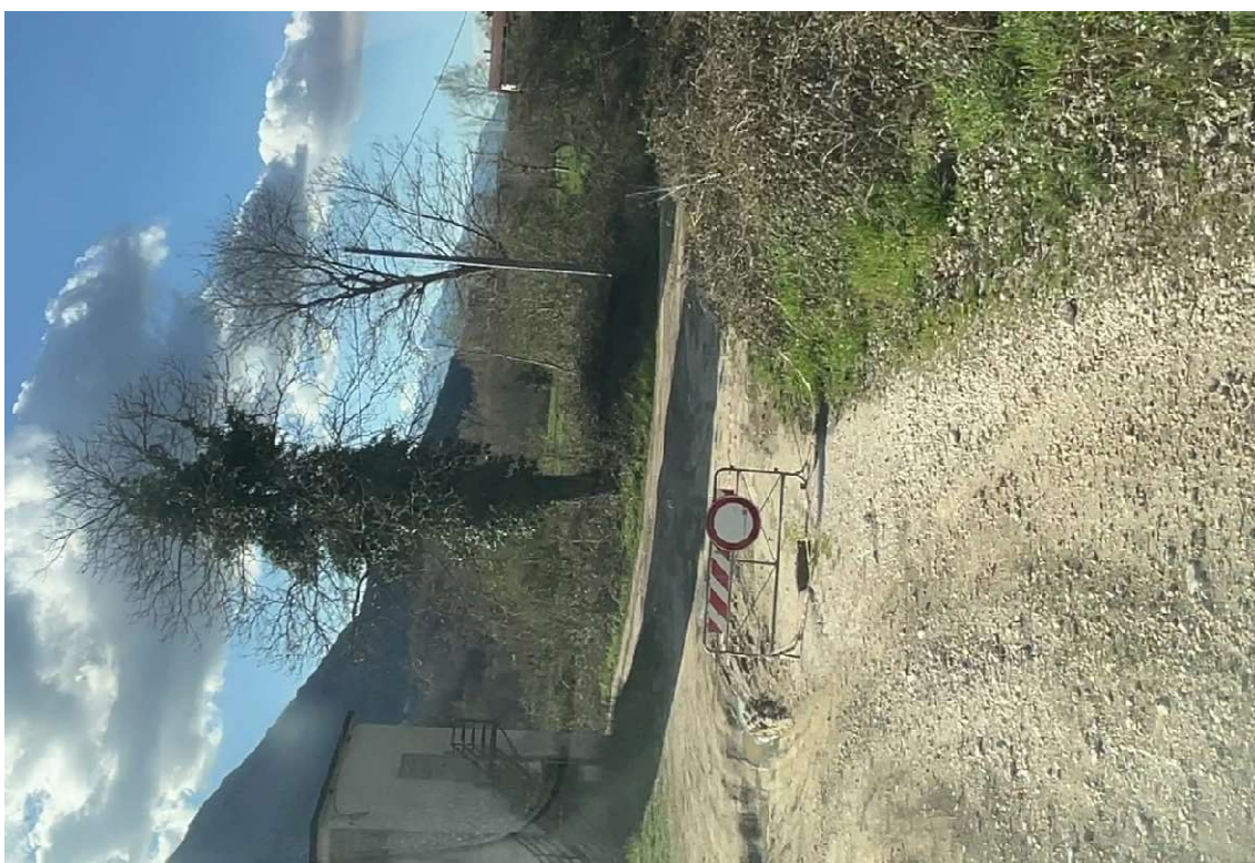
A19 – strada dissestata in prossimità di un collettore idrico collassato.
